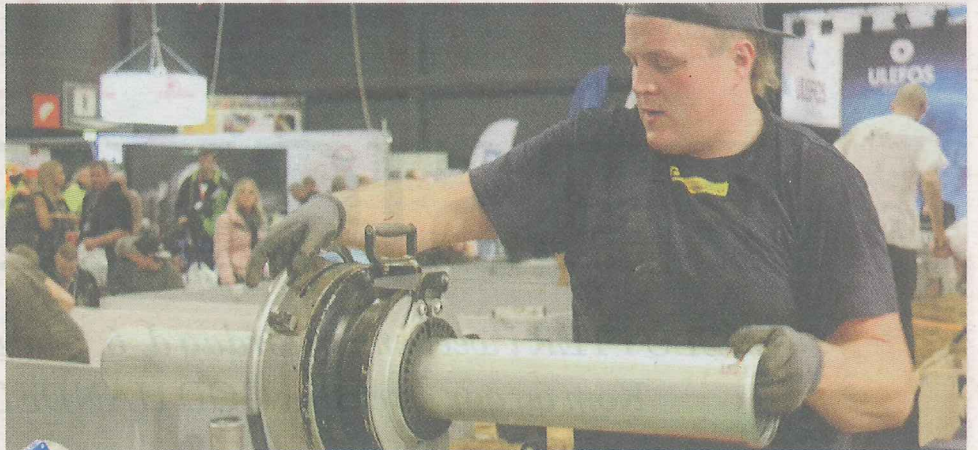
Buster Dammand Eggertsen fra Learnmark Horsens vandt sølv til DM i rørlægning. Foto: Learnmark Horsens
